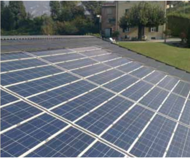
Bellagio (CO) - Abitazione privata Potenza impianto: 2,952 kWp.
