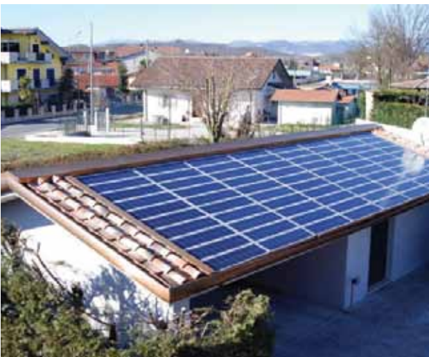
Ceccano (FR) - Abitazione privata Potenza impianto: 6 kWp.
