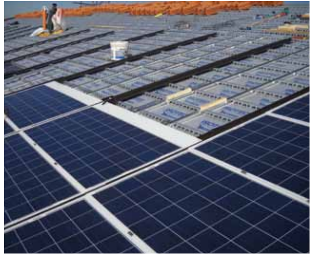
Roma - Complesso residenziale "Il borgo" Potenza impianto: 18,24 kWp. Installazione realizzata con ET 190.
