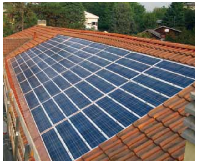
Carnate (MB) - Abitazione privata Potenza impianto: 6 kWp.
