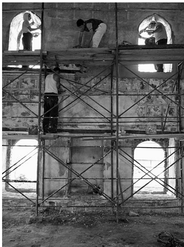
Figura 1.30 Applicazione dell'intonaco marmorino: per il rinzafo di cocchiopesto si è stesa una guida per accompagnare lo spessore del primo strato di intonaco all'irregolarità della superficie delle pareti (fonte: Elvane Islami)
