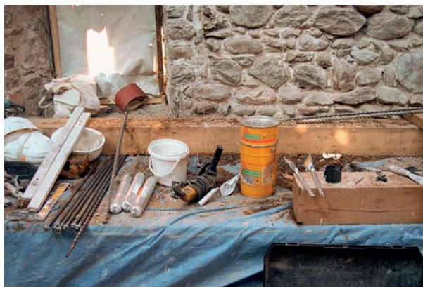
Figure 1.20 Trapano, punte, aspiratore, barre di acciaio, resina e induritore impiegati per unire la trave del solaio al muro
