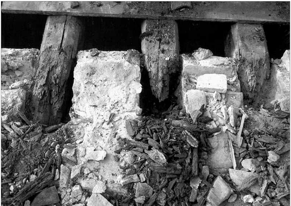
Fig. 1.6. Esempio di attacco di carie bruna sulle teste di travi in corrispondenza degli appoggi. Questo è il luogo privilegiato per la formazione di funghi, data la presenza di umidità, specie di risalita o condensa.
