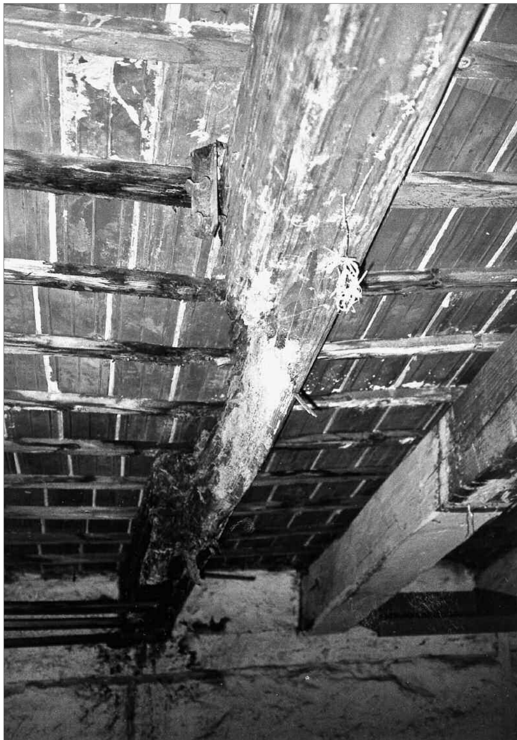
Fig. 1.2. A contatto con l'acqua – di infiltrazione in questo caso – i batteri fanno da "apripista" a muffe e funghi cromogeni. Ad essi sopravvivono le cosiddette carie (basidiomiceti e ascomiceti). Infine a completare l'opera, gli insetti.
