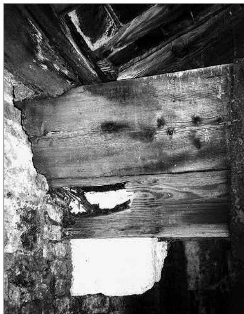
Fig. 1.8. L'attacco fungino sulla mensola ha di fatto vuotato l'elemento, facendo abbassare l'intera capriata. Anche la catena è tagliata in corrispondenza dell'appoggio. Si notano batteri fitogeni, anche sul muro, muffe e carie.
