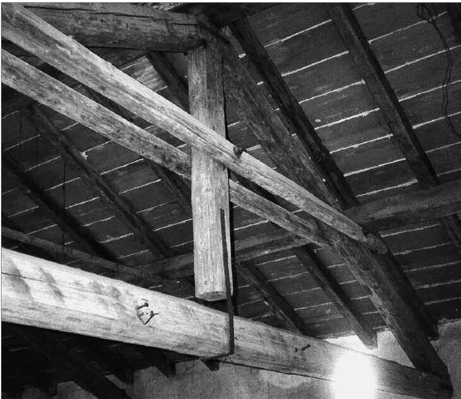
Figura 3. Spesso la concezione strutturale dipende da situazioni locali. In questa capriata (copertura in Friuli) è stata prestata grande attenzione per contrastare il sisma. La struttura è infatti chiusa, ben intelaiata e non spingente, specie nello sporto del tetto e nel serraggio delle terzere.
