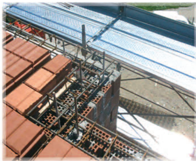
In basso: particolare del collegamento in copertura tra la struttura in Muratura Armata POROTON® e solaio
