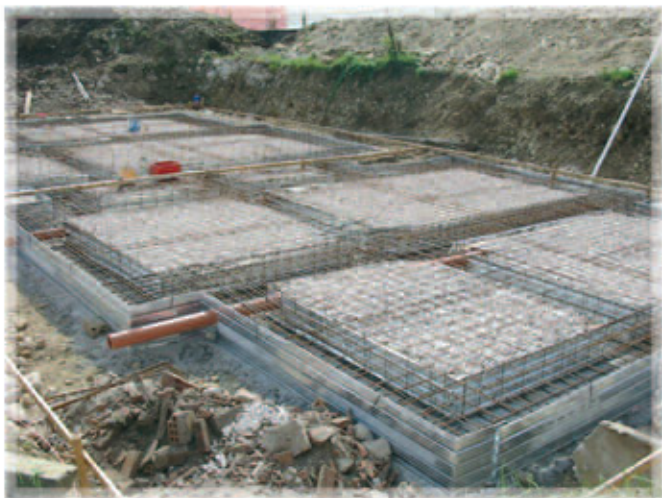
In alto: vista del piano di fondazione prima della fase di getto delle travi rovesce in c.a.
